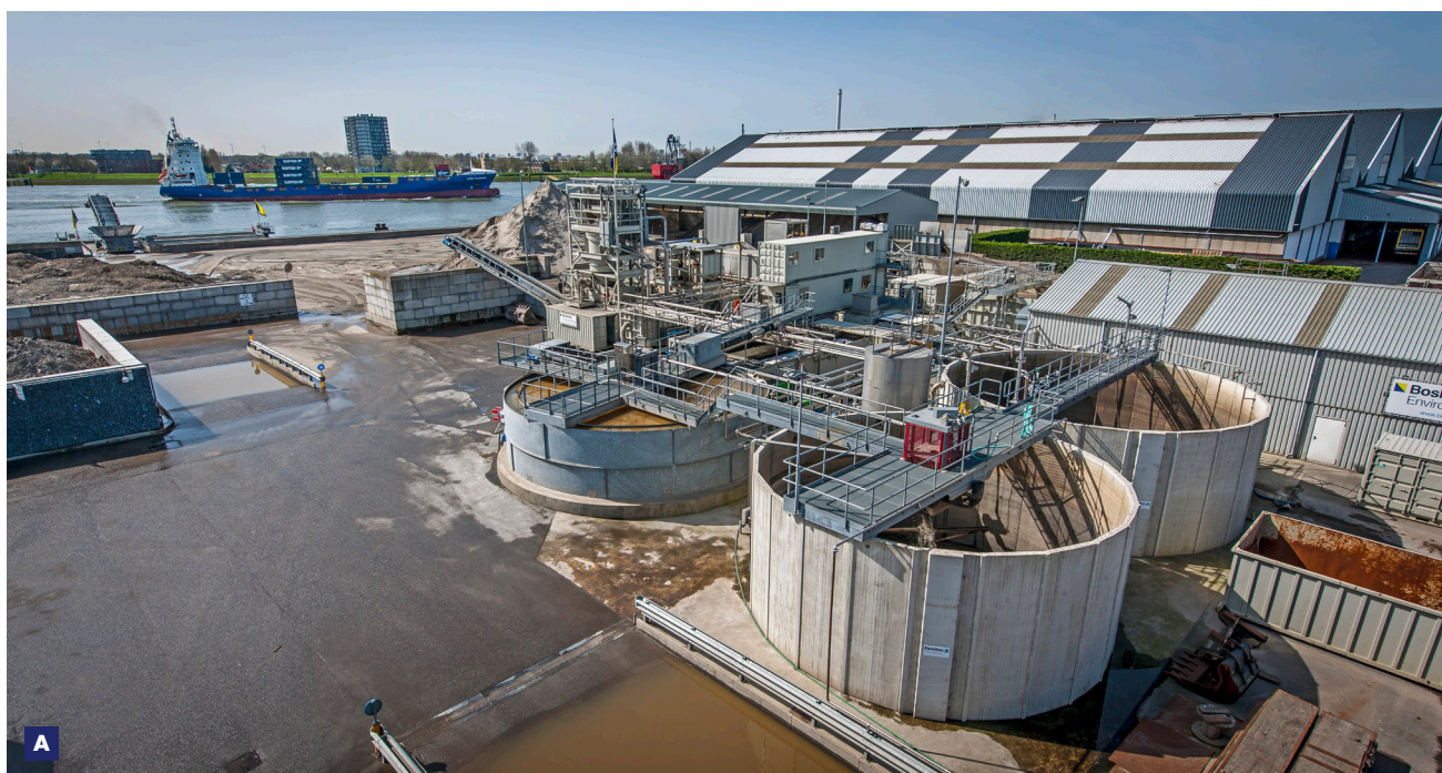
A Grondreinigingsinstallatie in Schiedam
