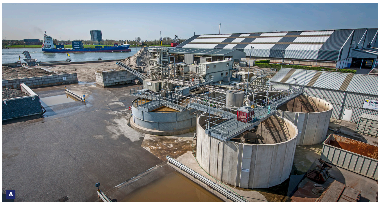
A Grondreinigingsinstallatie in Schiedam
