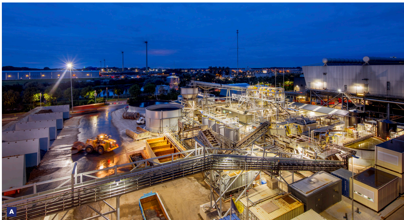
A Bodemasreinigingsinstallatie in Alkmaar
